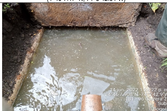
Foto No 4. Primera cámara pozo séptico (4°46'7.908" N, 74°3'42.9"W)
