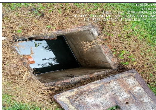
Foto No 3. Caja de paso anterior a pozo séptico procedente de lavadero, lavaplatos, baños y área de ropa. (4°46'7.884" N, 74°3'42.684"W)
